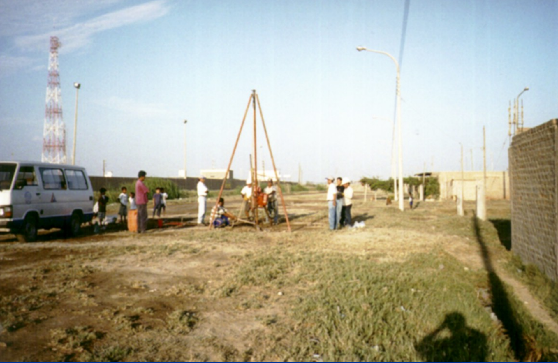
Realizando el Ensayo de Penetración Estándar (SPT), por el personal del Laboratorio Geotécnico del CISMID - UNI
