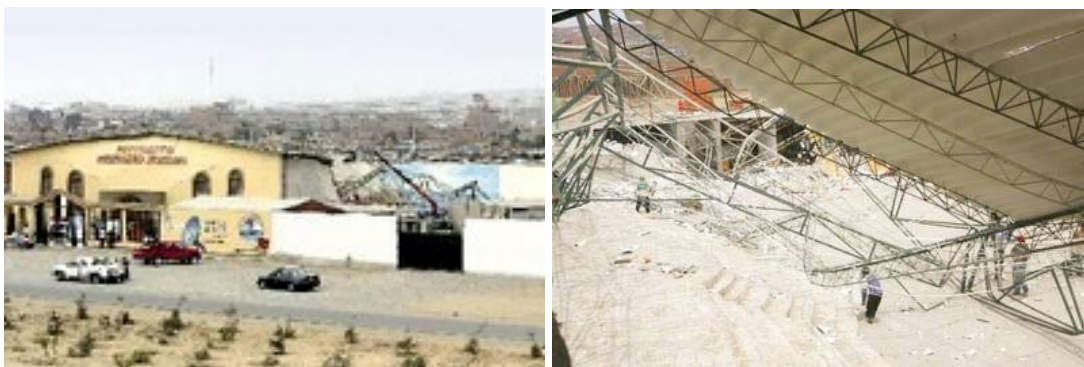
Figura 9. Muros y techo de iglesia colapsada, Villa El Salvador. (Fotos: El Comercio, Perú 21)
